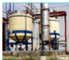
●タンクの腐食
