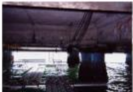
●橋げたの老朽化
