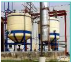
●タンクの腐食
