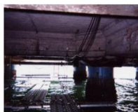
●橋げたの老朽化
