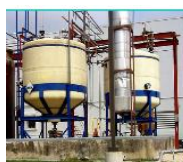
●タンクの腐食
