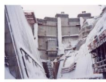
●ダムコンクリートの割れ
